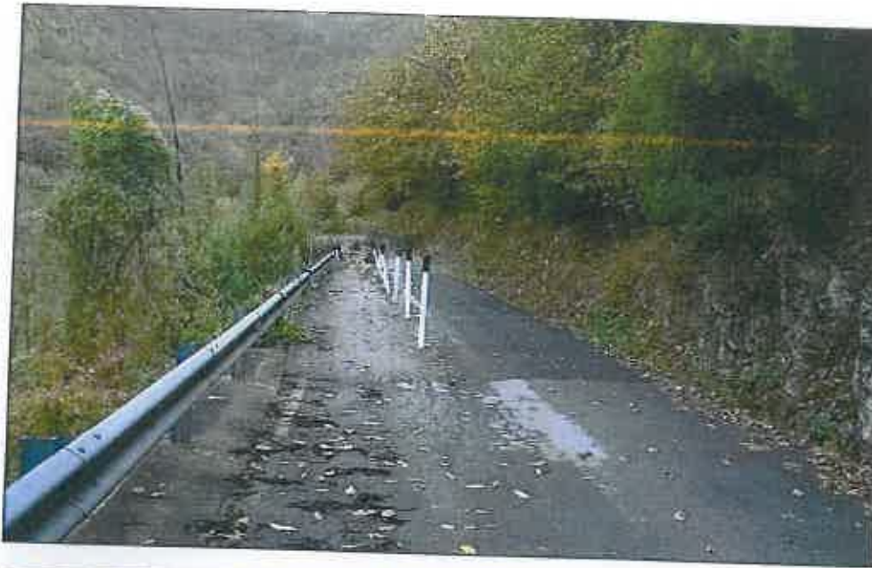
Foto 1 - Veduta verso ovest del tratto di viabilità della S.P. 15 interessata da collasso del piano viario e oggetto delle opere di consolidamento previste a progetto. Per ragioni di sicurezza, il transito veicolare è limitato alla corsia di monte.
