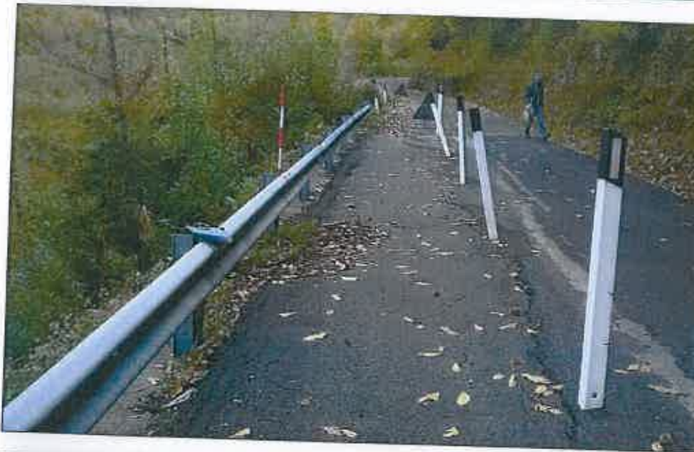
Foto 2 - Ripresa della corsia lato sinistro della S.P. 15 caratterizzata da cedimento della piattaforma stradale e formazione di lesioni di trazione, continue e di forma irregolare. È possibile osservare il ripristino della pavimentazione mediante stesa di un nuovo manto asfaltico.
