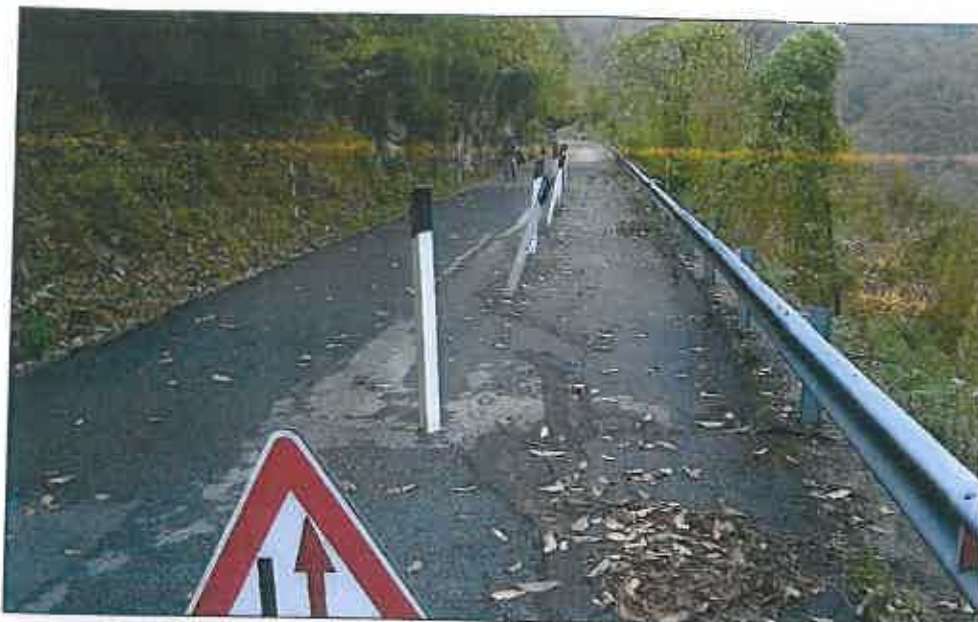
Foto 4 - Vista verso Est, lato destro, della S.P. 15, nel tratto di studio. Oltre alla parziale compromissione del corpo stradale, si rilevano la deformazione del dispositivo di protezione laterale (guard-rail) e il restringimento della viabilità mediante il posizionamento di delimitatori fissi.
