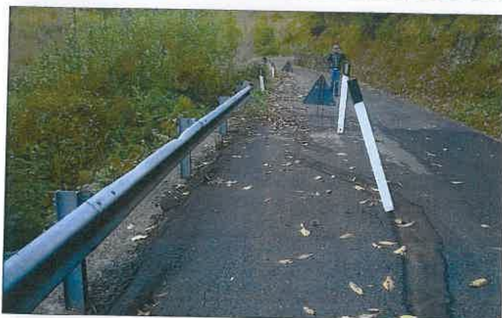
Foto 5 - Tratto occidentale della viabilità in oggetto caratterizzata da cedimento della superficie viaria, fratture di trazione e sigillatura delle lesioni del manto asfaltico.
