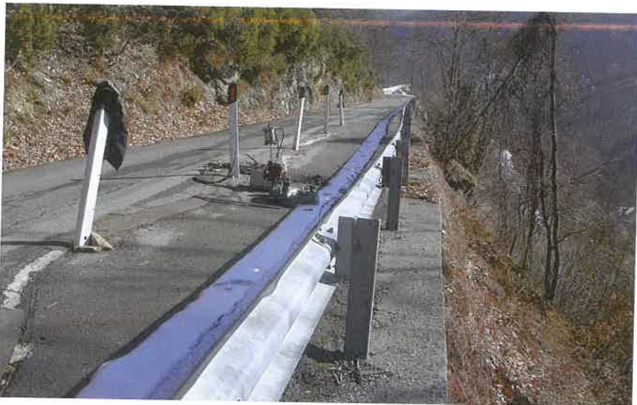
Foto 1 – Panoramica della zona di intervento e ubicazione della prova penetrometrica DP1 (vista da ovest); i delineatori stradali evidenziano l'allineamento delle crepe formatesi sul manto stradale, temporaneamente chiuse con malta cementizia e bitume in attesa dei lavori a progetto.
